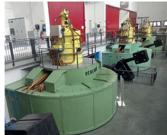
Casa de máquinas
