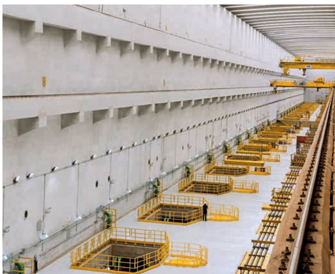
Sala de máquinas
