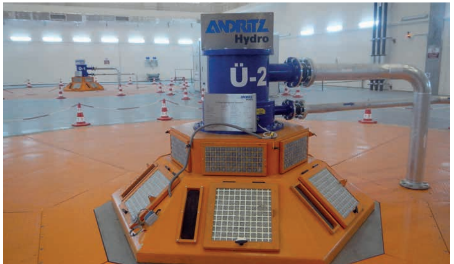
Sala de máquinas
